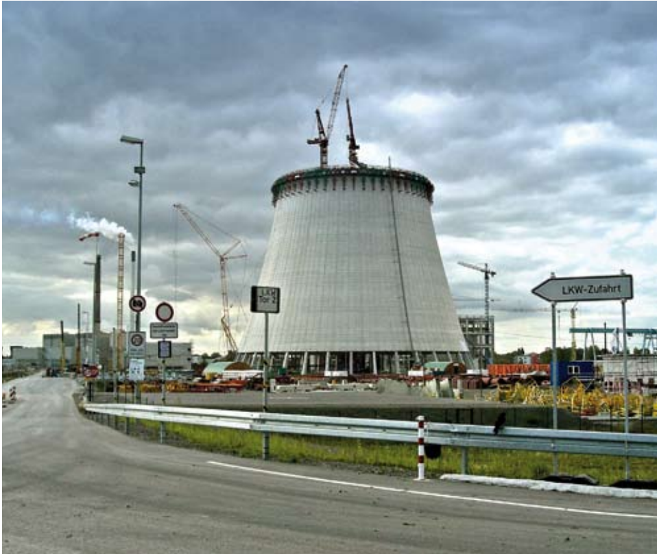
Der zur Hälfte fertige Kühlturm des neuen Kohlekraftwerkes in Datteln. Umweltschützer haben im September 2009 einen Baustopp erzwungen.
